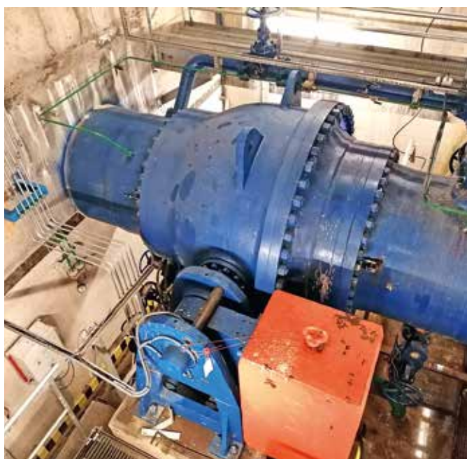
■ Hlavní uzavírací armatura v Doğançay
