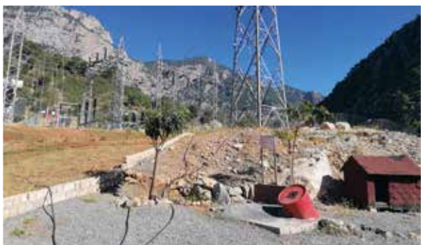
■ Okolí elektrárny – rozváděcí soustava
